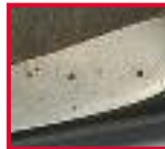
Voorbeelden van putcorrosie
